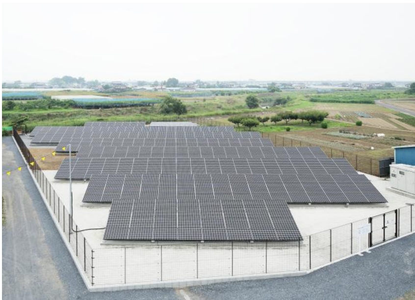
「TOTETSU 蓮田ソーラーステーション」 全景
