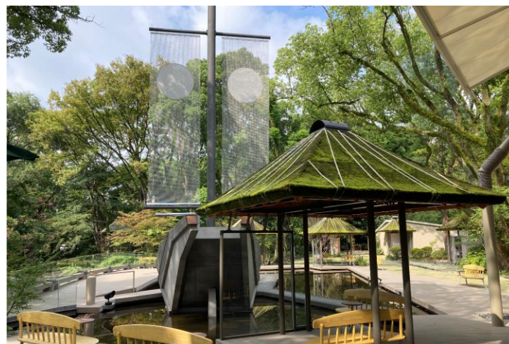
熱田神宮 くさなぎ広場東屋屋根苔緑化
